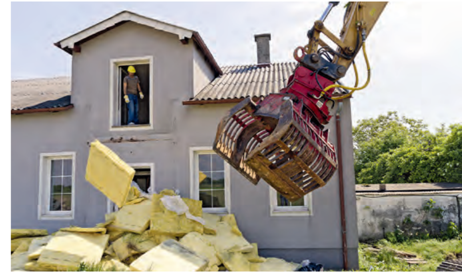
Beim Bau unverzichtbar: HBCD-haltige Dämmplatten
